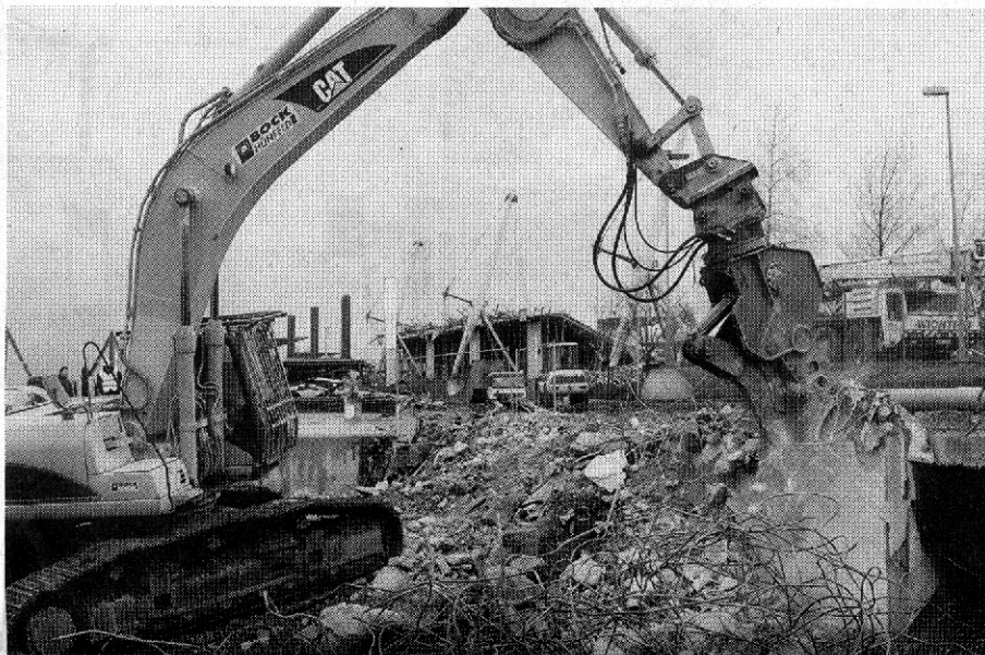
Von der Gebr. Steck GmbH aus Rammingen kommen am Nürburgring Greifer, Pulverisierer und die neue Abbruchscher S32 mit Universalgebiss zum Einsatz. Fotos: Steck
