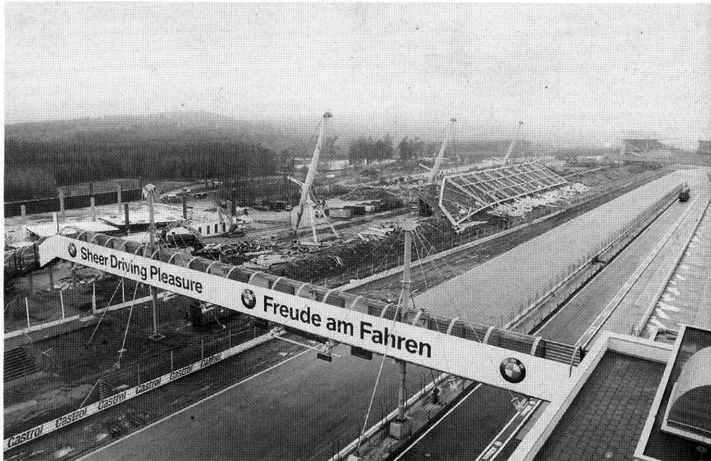
Auf der Baustelle am Nürburgring laufen die Steck-Geräte zuverlässig. Bock hat die meisten der eingesetzten Geräte zwar gekauft, greift jedoch zur Überbrückung auch immer wieder auf den Abbruchgeräte-Mietpark von Steck zurück.
